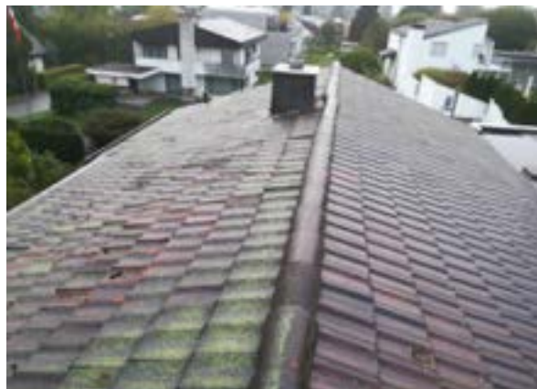
Figure 13: Certaines tuiles sont ébréchées. Il est conseillé de réparer la toiture avant d'envisager la pose d'une installation solaire et de contrôler les parties subjacentes.
