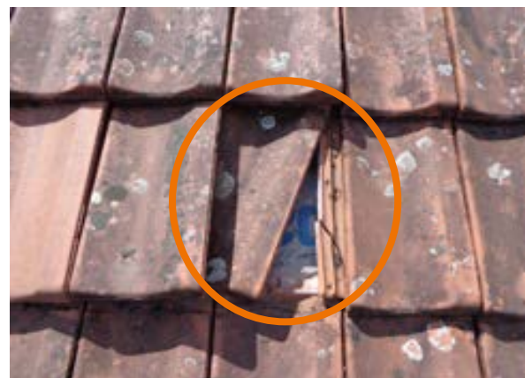
Figure 12: Même si le matériau de couverture semble en bon état, il peut y avoir des vices cachés !
