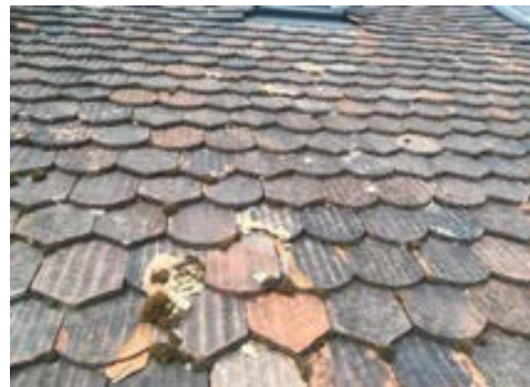
Figure 14: Les tuiles sont légèrement ébréchées sur toute la surface. Dans ce cas il est conseillé de rénover la toiture avant la pose d'une installation solaire.
